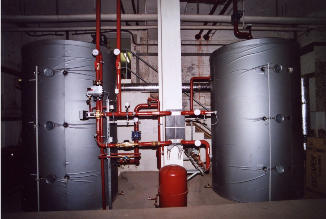
Abbildung 3: Solarpufferspeicher 2 x 5.000 l, Foto während der Montage aufgenommen, deshalb noch keine Wärmedämmung auf den Rohrleitungen
