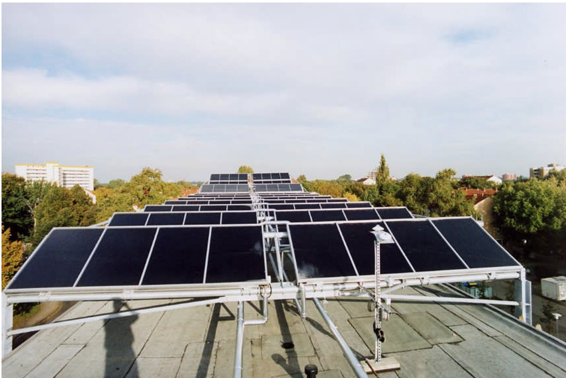
Abbildung 3: Gebäude Magdeburger Str. 2, Kollektorfeld über dem Trockenboden
